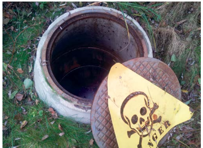
Sickerwassersammler, in dem die Proben für die Analyse im Zusammenhang mit der Hausmülldeponie entnommen wurden.
